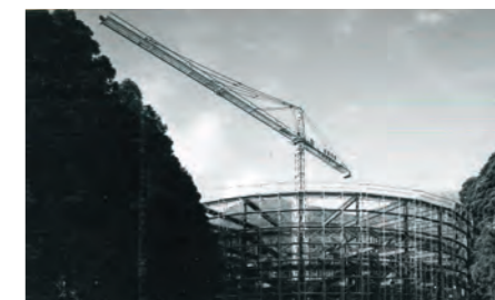
建設中の箱根プリンスホテル(現・ザ・プリンス 箱根芦ノ湖)
